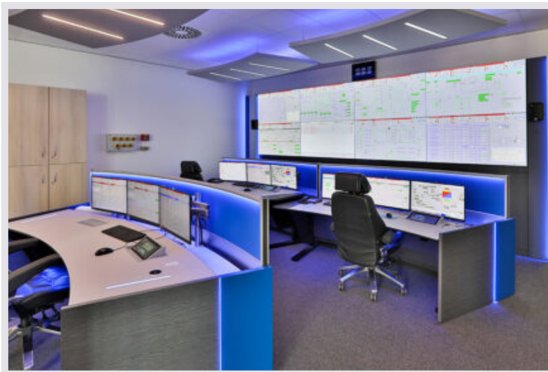
Stadtwerke Schwerin, Kraftwerk Süd
