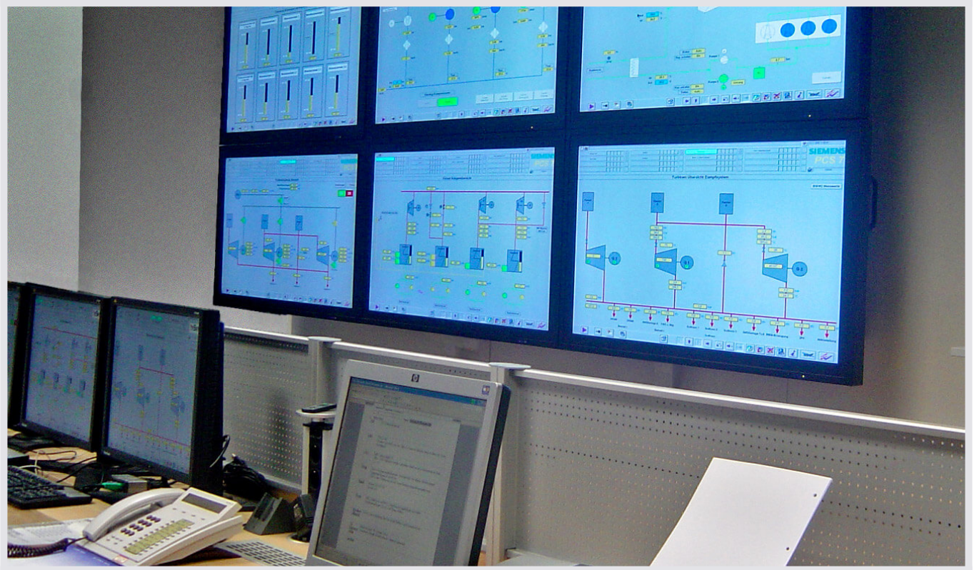
Brauerei Beck, Bremen - Leitwarte von JST
