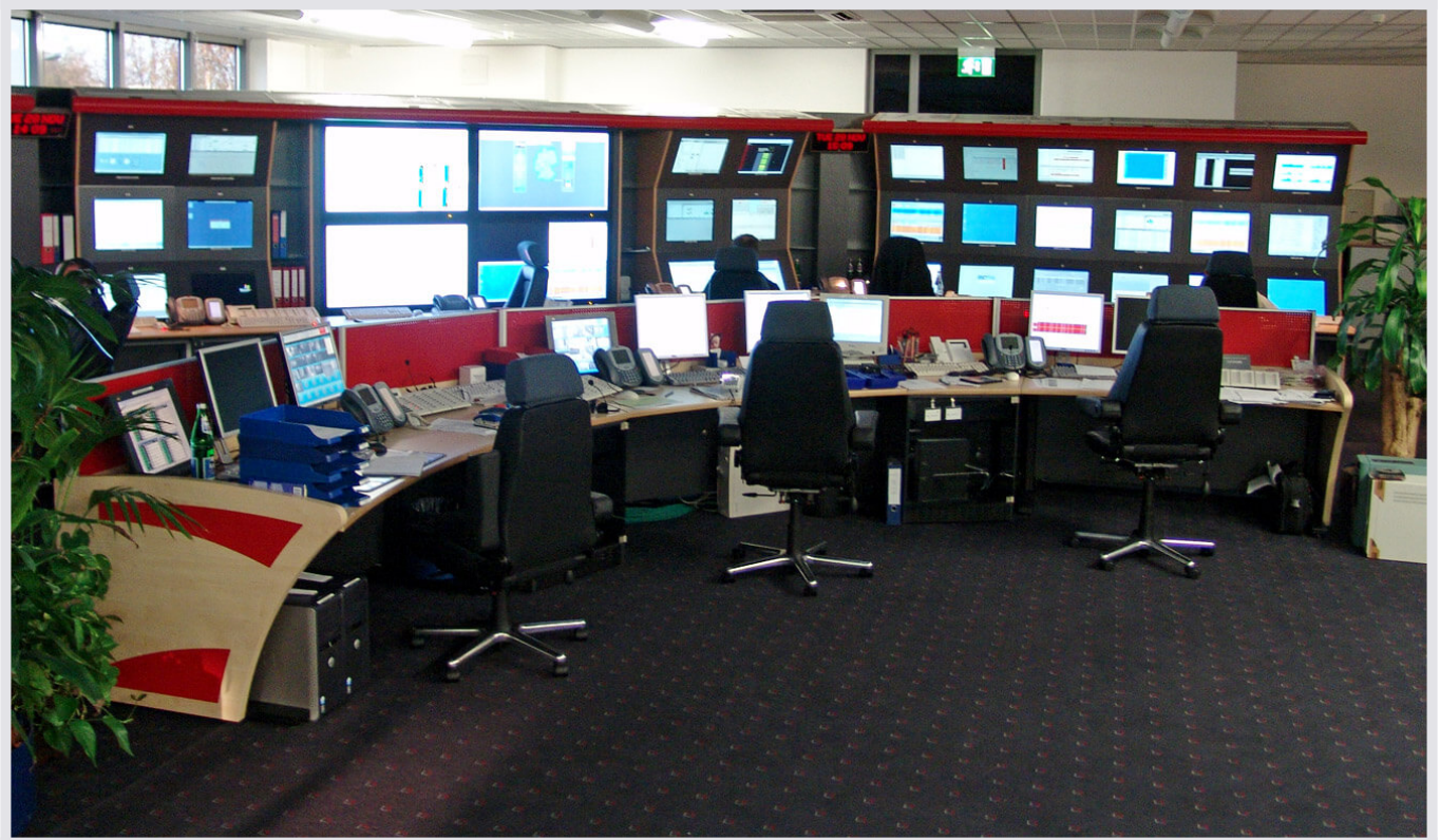
Versatel Essen. Netzbetriebszentrum.
